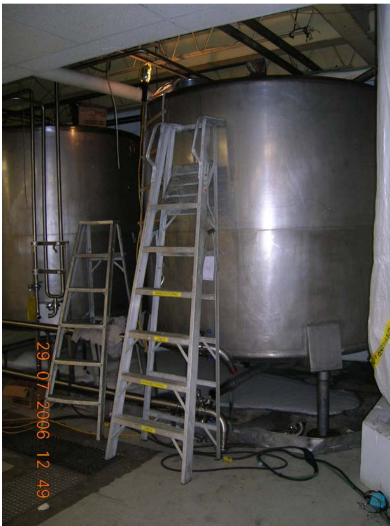
Aperçu du lieu de l'accident (source : CSST)
